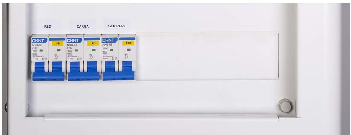
Ilustración 3. Protecciones de alterna para el Sunbox Lite sin conmutación
